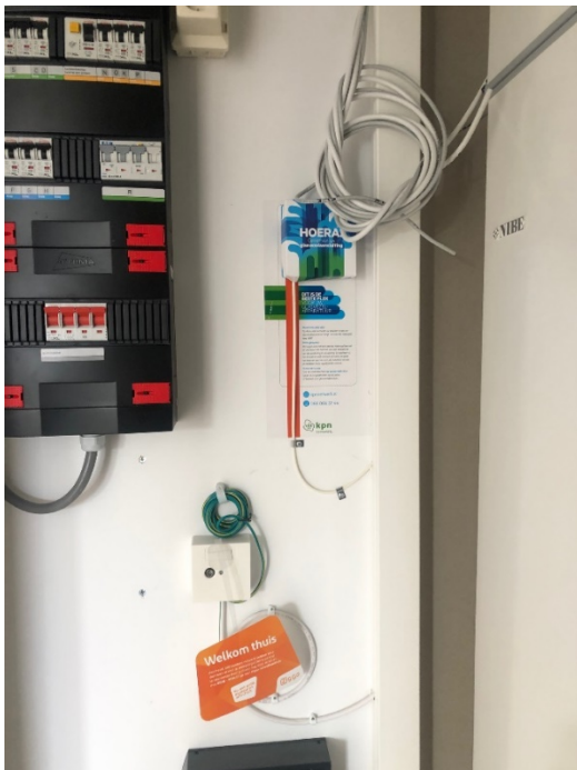
In je berging: electragroepen, montage glasvezel en kabel
